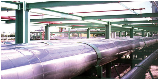
LNG Terminal Pipe Insulation
